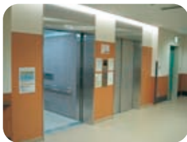
C2 エレベーター
